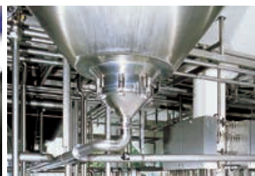
Nádrže a zásobníky
